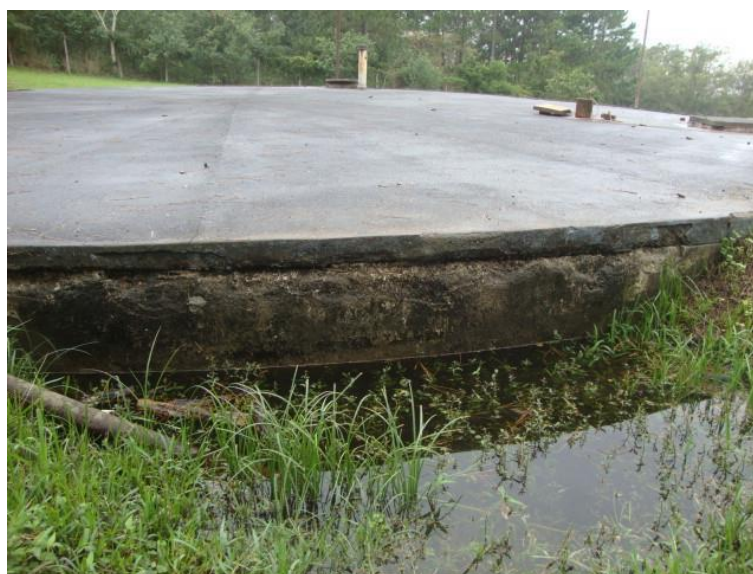
Figura 11- Reservatório de Compensação – Ausência de sistema de drenagem. Fonte: SMS Santa Maria RS
