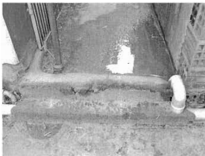
Figura 45 - Obras construtivas e/ou reparativas, executadas de maneira não técnica, improvisações que podem causar tombos, escorregões ou tropeços.
