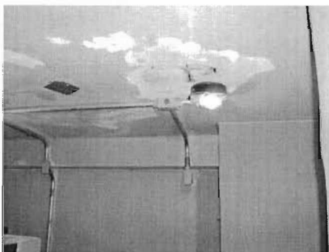
Figura 11 – Imagem da decomposição do teto de alvenaria, no qual deve receber acabamento de reboco e pintura resistente.
