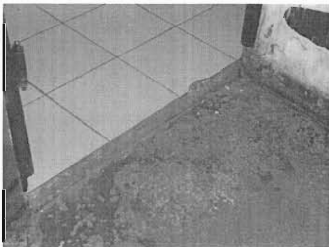
Figura 10 – Detalhe do degrau (desnível) no piso na entrada de um dos banheiros.
