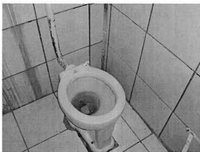
Figura 29 – Condição do vaso sanitário de um dos banheiros da catacumba.
