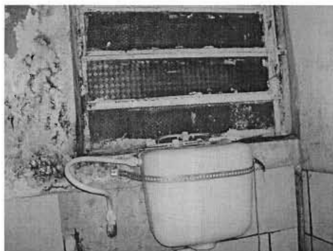
Figura 30 – Báscula e parede em condições precárias, no mesmo local da figura anterior.
