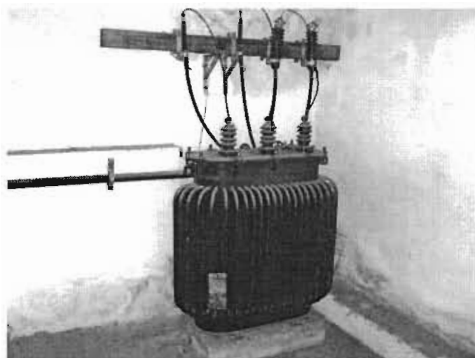
Figura 21 – Transformador de energia elétrica (subestação de energia elétrica).
