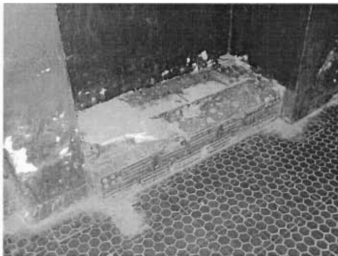
Figura 36 – Degrau junto a parede de alvenaria que pode ocasionar tombos, tropeços ou escorregões.
