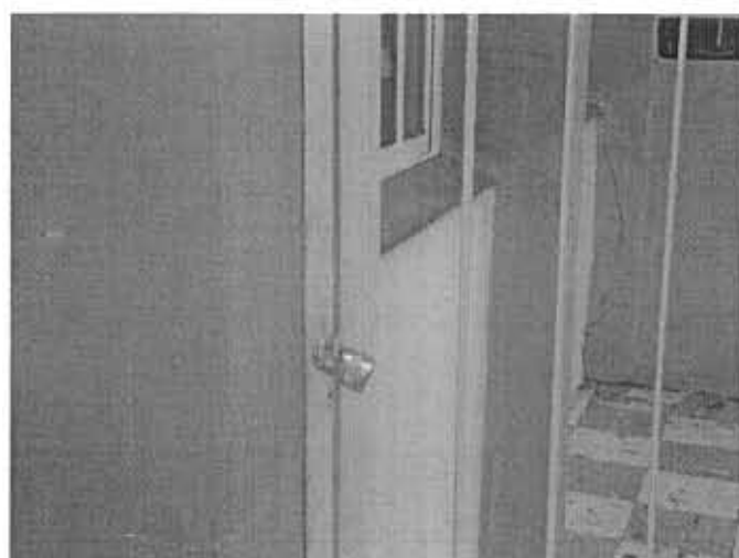
Figura 54 – Outra extremidade da grade de proteção, restringindo o acesso a rampa destinada ao acesso de cadeirante, com cadeado.
