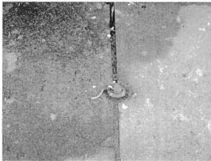
Figura 44 – Saliência no piso externo, necessitando sua remoção. Provável bastão de aterramento em desuso.
