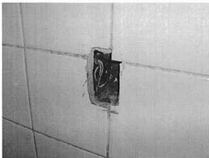
Figura 35 – A figura refere-se a provável retirada de tomada elétrica, em desuso ou desativada, devendo neste caso ser dotada de espelho cego.
