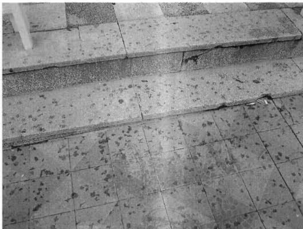
Figura 1 – Refere-se aos degraus de acesso, do passeio público (calçada) para as dependências da Casa do Estudante, sem instalação de rampa prevista no Código de Edificações Municipal.
