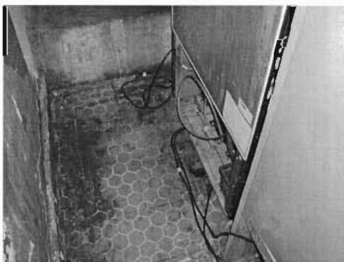
Figura 37 – Disposição da fiação elétrica rente ao chão.
