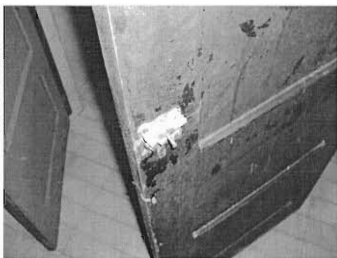
Figura 13 – A imagem demonstra a avaria da fechadura interna de uma das portas do gabinete sanitário do banheiro feminino.
