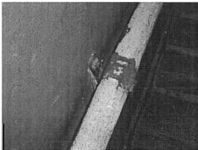
Figura 7 – Detalhes do corrimão referido, apresentando-se danificado, com ferrugem e saliências que podem provocar cortes ou arranhões.
