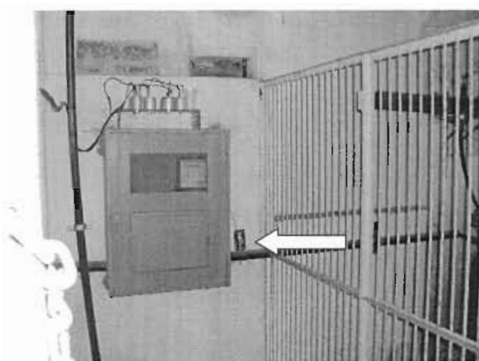
Figura 22 – Sala do transformados e sua barreira metálica de proteção. Nota-se no detalhe a presença de uma lata de refrigerante.
