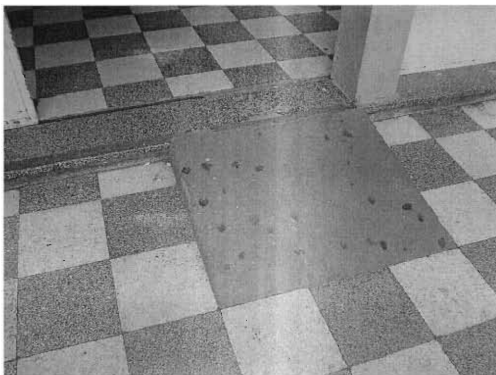
Figura 2 – Na porta de acesso principal ao prédio há instalada rampa, mas para chegar nesta deve-se vencer o obstáculo demonstrado na figura anterior (figura 1).
