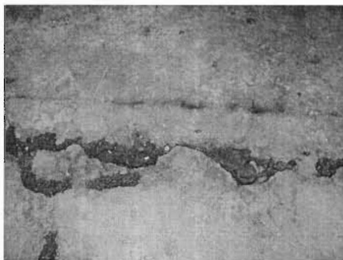
Figura 9 – Detalhe do piso de cimento, com fissuras e/ou rachaduras.
