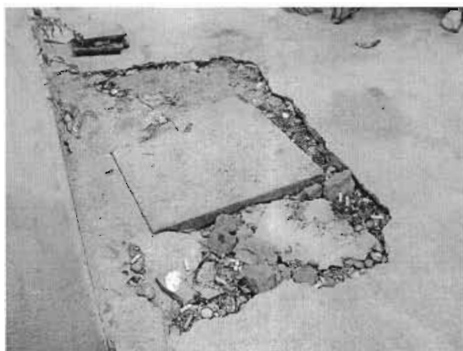
Figura 42 – O piso da área externa danificado, necessitando ser restaurado.
